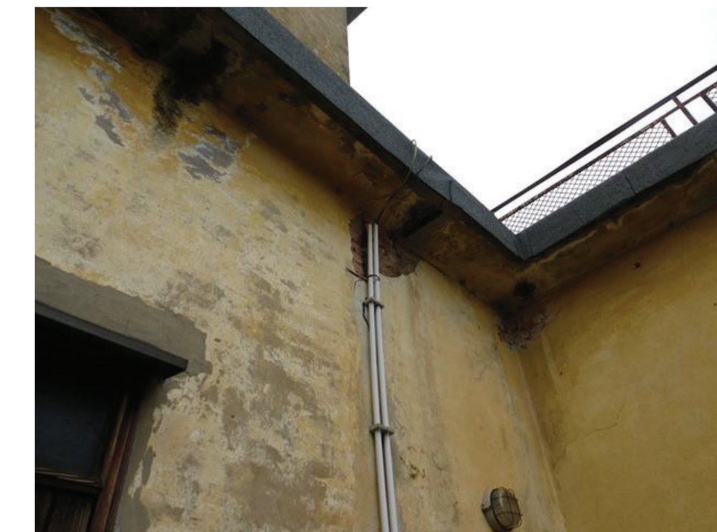
DEGRADO DELLA CORNICE IN C.A.
