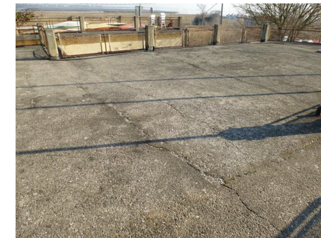
DEGRADO DELLA PAVIMENTAZIONE DELLA TERRAZZA
