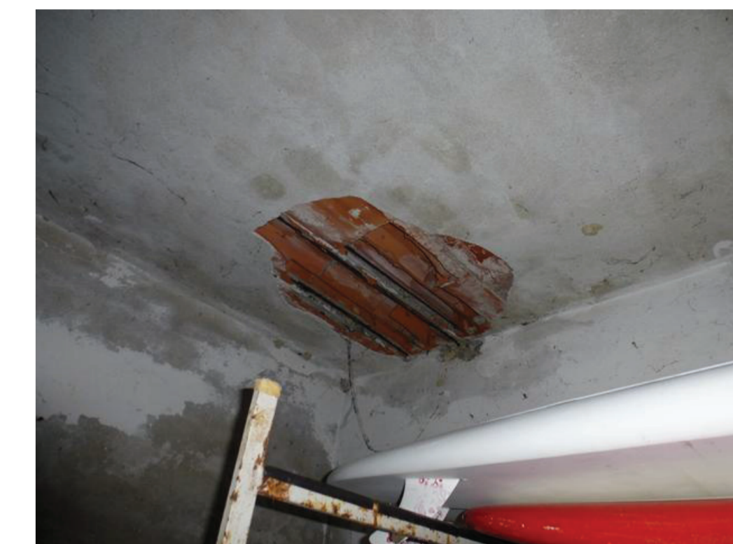
DEGRADO DEL SOLAIO IN LATEROCEMENTO
